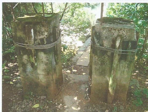
Foto 2: Acesso à Ponte - detalhe dos pilares que dão sustentação aos cabos de aço que percorre a ponte. Novembro/2010. Foto: Adriana Ferreira
